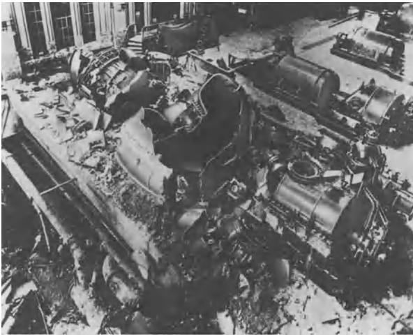
Bild 2.4 Folgeschäden des infolge Überdrehzahlen zerborstenen Turbinenläufers
